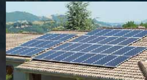
Centro Italia: sistema fotovoltaico connesso alla rete da 8 Kwp.
