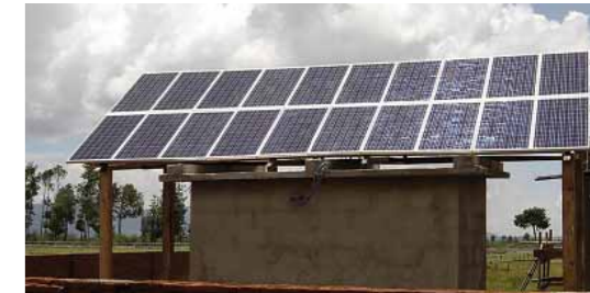
Africa centrale: sistema fotovoltaico autonomo da 4Kwp.
