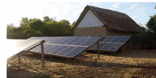
Madagascar: sistema fotovoltaico autonomo da 4Kwp.
