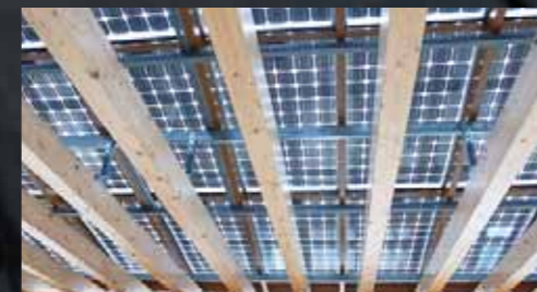
Nord Italia: sistema fotovoltaico integrato da 10Kwp con modulo custom.
