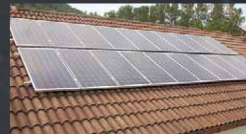
Centro Italia: sistema fotovoltaico connesso alla rete da 3Kwp.
