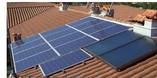
Centro Italia: sistema fotovoltaico connesso alla rete da 3Kwp e solare termico.
