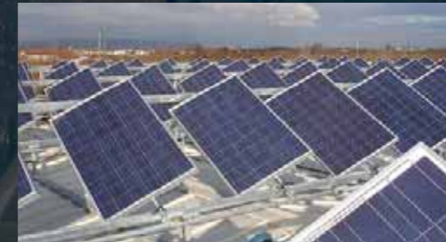
Nord Italia: sistema fotovoltaico da 50 Kwp con inseguitore solare.
